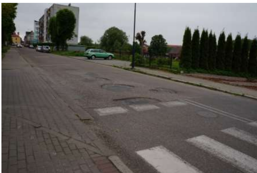
Fot. 12. Stan nawierzchni drogi ulicy Zamkowej
