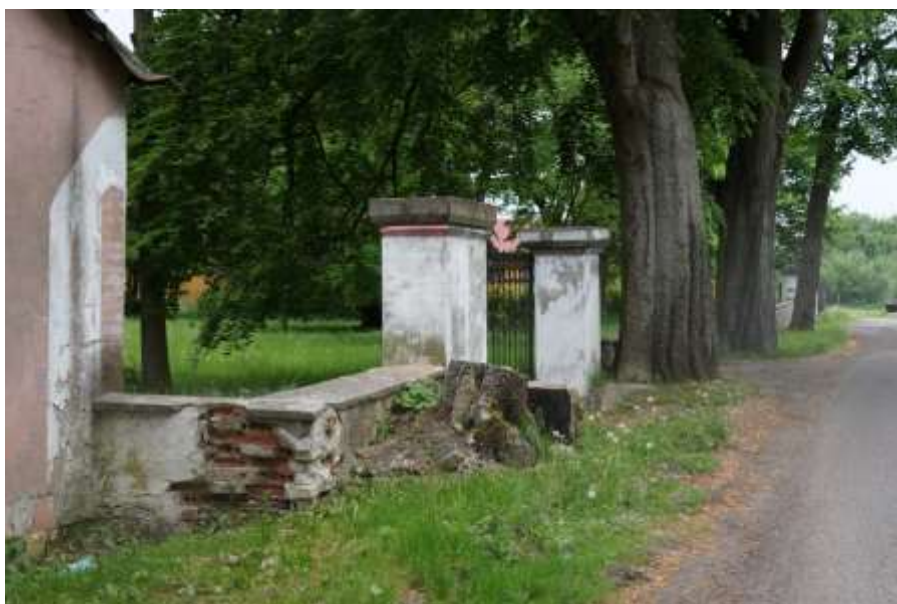
Fot. 47. Zdeprawowana brama wjazdowa do pałacu w Naclawiu
