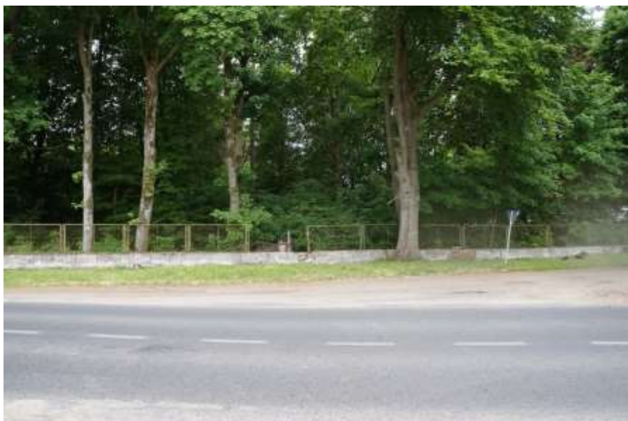
Fot. 45. Zdewastowane ogrodzenie przy parku pałacowym w Naclawiu (teren prywatny w sąsiedztwie Świetlicy Wiejskiej – tj. centrum wsi)
