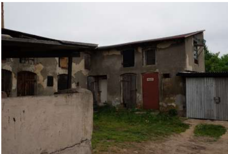
Fot. 19. Zdewastowane obiekty gospodarcze przy ul. Koszalińskiej
