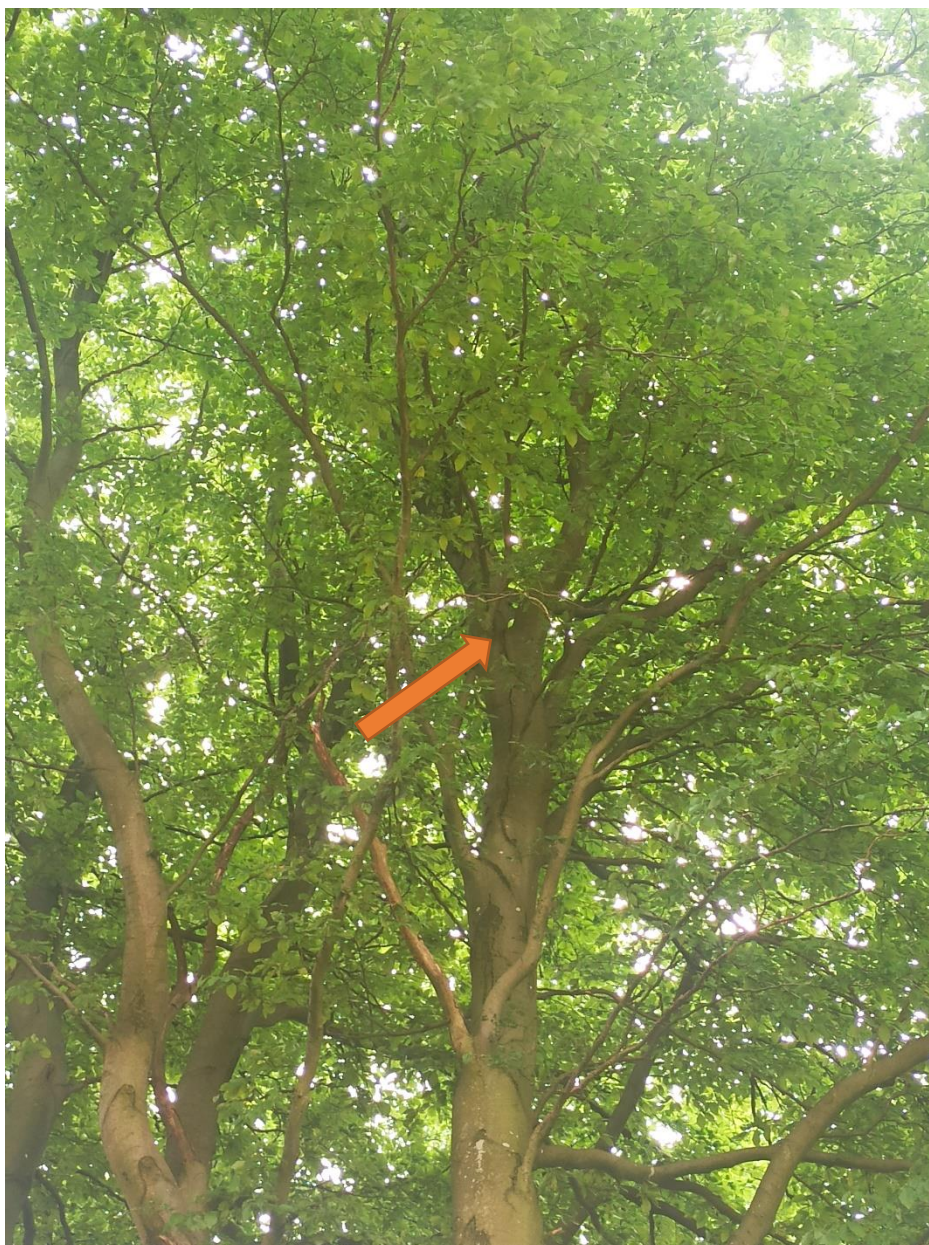
Rozwidlenie przewodnika NW z pęknięciem do kontroli
