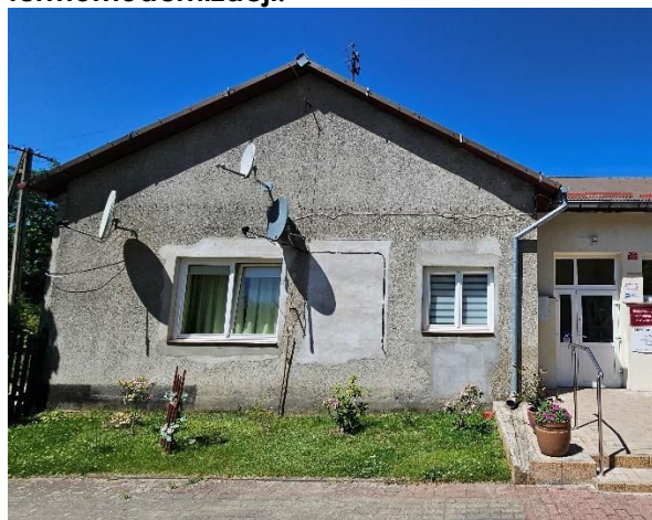
Środowiskowy Dom Samopomocy „Oaza” – infrastruktura wymagająca termomodernizacji.
