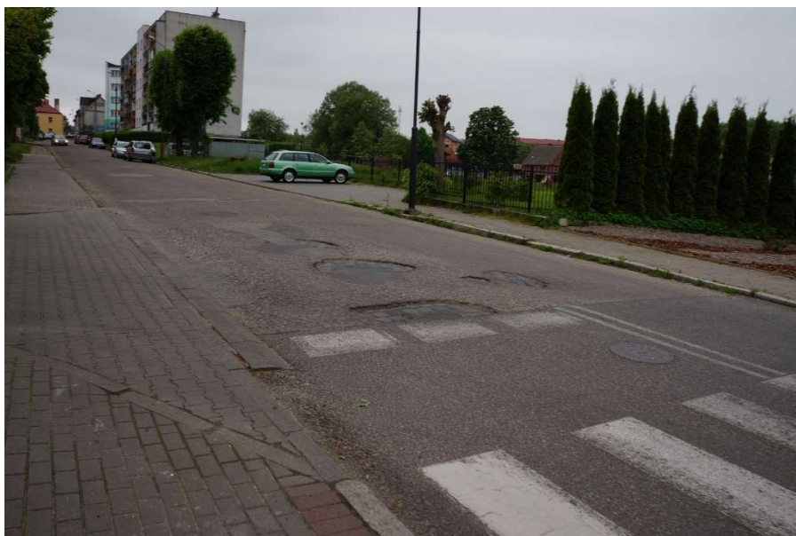
Fot. 12. Stan nawierzchni drogi ulicy Zamkowej
