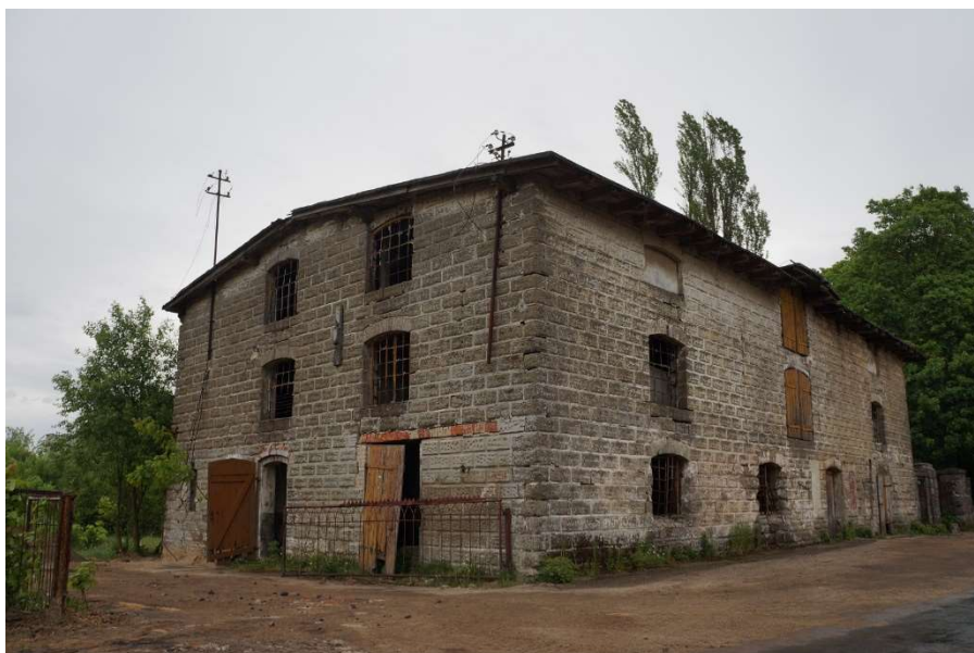
Fot. 35. Zdewastowany obiekt gospodarczy w centrum miejscowości (miejsce przewidziane w planach Gminy do utworzenia świetlicy wiejskiej)
