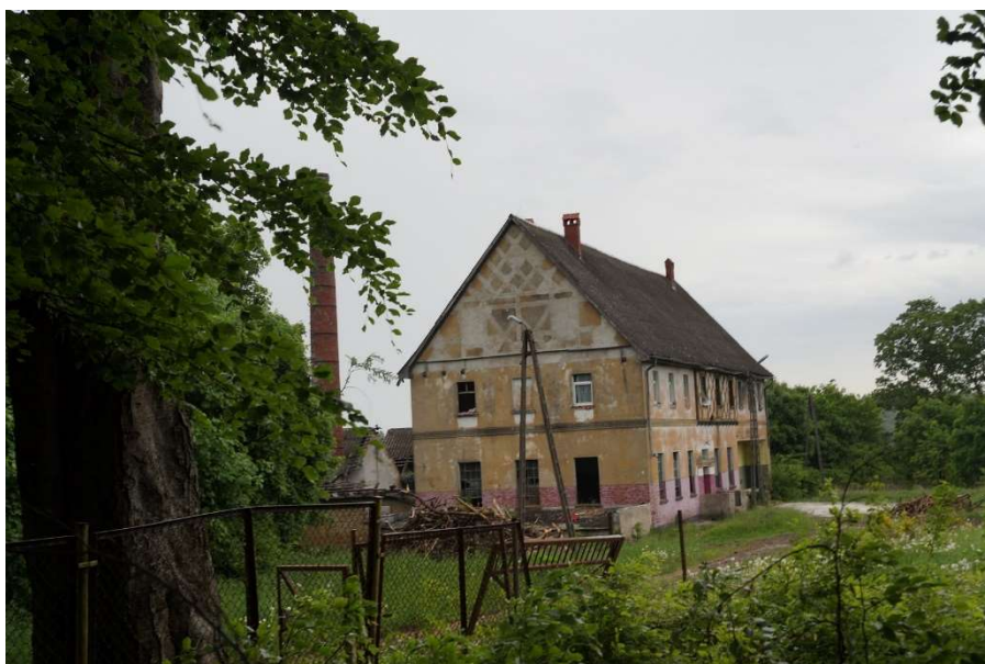
Fot. 34. Zły stan techniczny obiektów budowlanych
