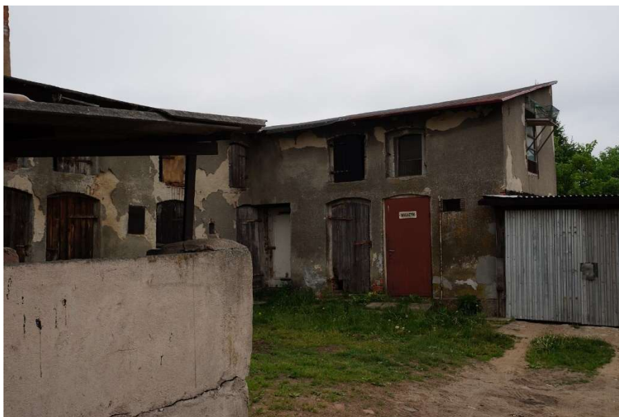
Fot. 19. Zdewastowane obiekty gospodarcze przy ul. Koszalińskiej
